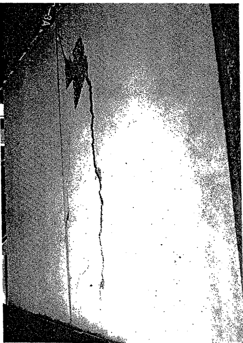
Bruddet set nedenfra.
