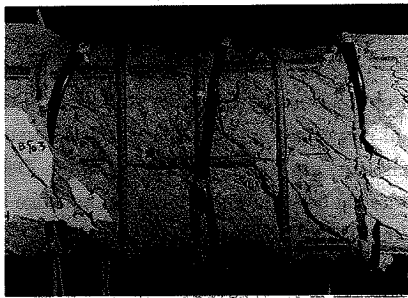
Billede 6.6 : Bjælke efter brud. På grund af brudlinier mellem de langsgående armeringsstænger kan dæklaget uden videre skrælles af.
